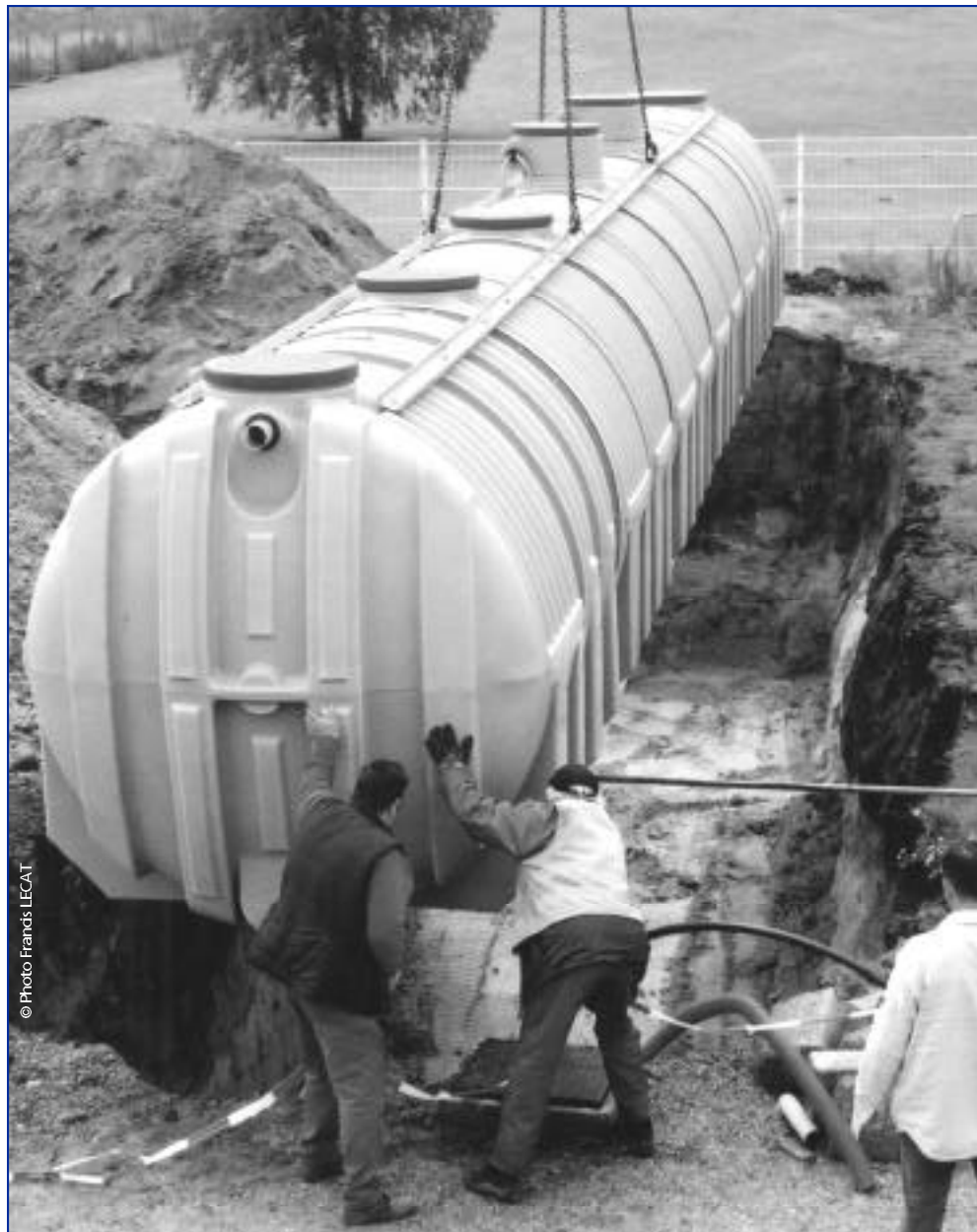
Depuis septembre, les services Serres et Espaces Verts ont été dotés d'une cuve de récupération des eaux de pluie.
